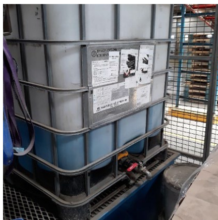
2. IBC (1000 L. tank) med sprinklervæske
